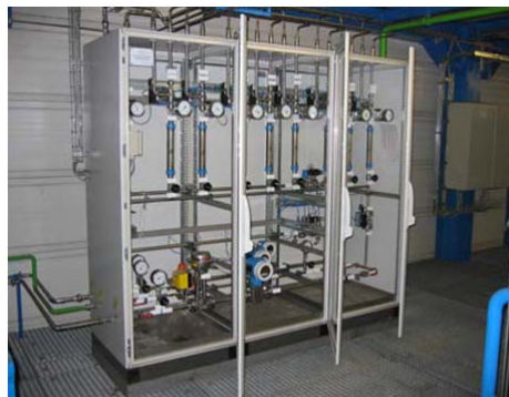
Fig. 3. Stația de mixare și măsură.
