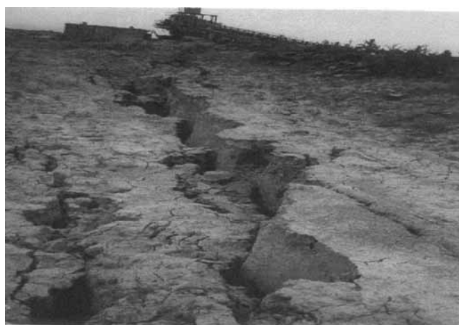
Fig. 9. Afectarea terenului și construcțiilor miniere de la suprafață (mina Dragotești, abataj 28/5 – anul 1997) [3]
