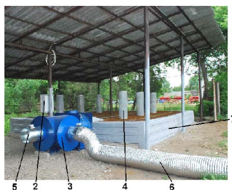
Fig. 1. Instalația de uscare a fânului vrac prin ventilare cu aer rece sau aer cald, IVF (model experimental): 1 – Panou solar asamblat; 2 – instalație electrică; 3 – echipament pentru ventilare; 4 – tuburi de ventilare; 5 – flanșe de admisie cu electromotor; 6 – tubulatură pentru circuit de aer cald; 7 – platforma de uscare/depozitare.
