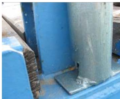
Foto 12. Talpa catargului antenei.
