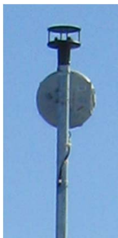
Foto 11. Antena poziționată pe direcția bază INCDM.
