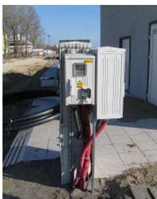
Foto 7. Tablou electric de alimentare a stației oceanografice din rețeaua de joasă tensiune.
