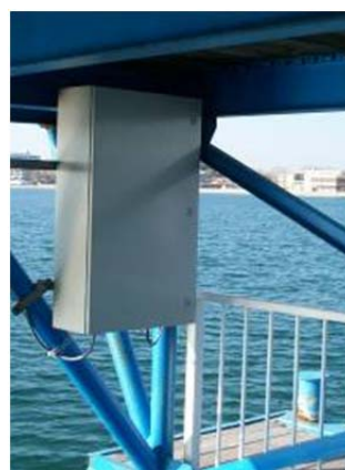
Foto 13. Casetă de alimentare cu energie, multiplexare, transmisie date.
