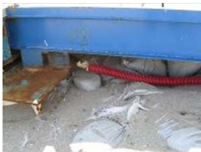
Foto 8 – Cablul de alimentare al stației oceanografice sub structura estacadei, după traversarea plajei.
