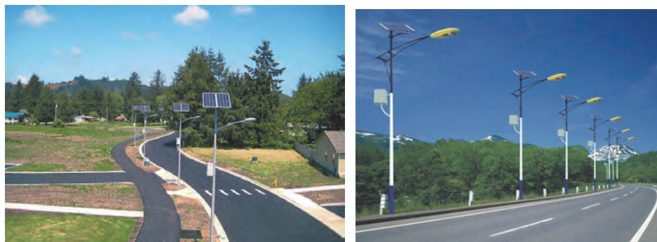
Fig. 12. Sisteme de iluminat fotovoltaice utilizate pentru iluminatul strazilor cu trafic auto.
