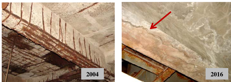
Fig. 6. Grindă de beton armat consolidată cu beton armat. Comportare necorespunzătoare în exploatare (zona B) [1].
