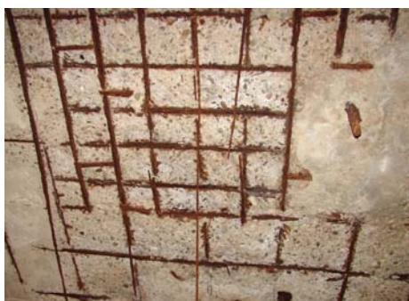
Fig. 3. Nivel maxim de deteriorare din cauze de durabilitate la planșeu din beton armat, zona B (2004) [5].
