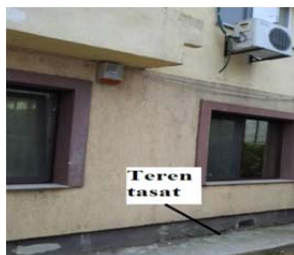
Fig. 3a. Influența tasării de către aparatele de aer condiționat (foto autor).
