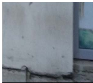
Fig. 1a. Crăpătură la nivelul trotuarului (foto autor).
