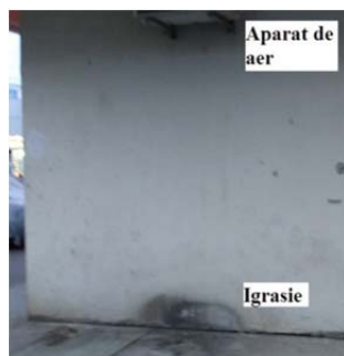
Fig. 3b. Apariția igrasiei și din cauza aparatelor de aer condiționat (foto autor).
