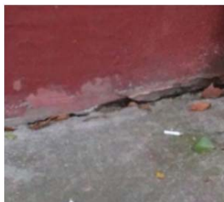
Fig. 1b. Crăpătură la nivelul trotuarului (foto autor)
