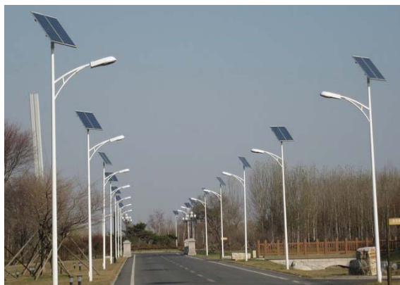
Fig. 2. Iluminat fotovoltaic stradal [10].
