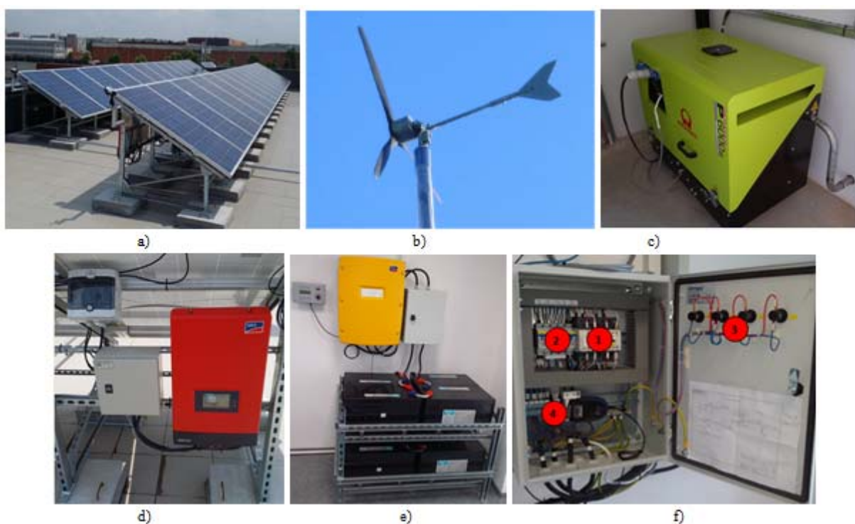
Fig. 8. Sistemul hibrid de producere a energiei electrice din surse regenerabile: a) panouri fotovoltaice; b) turbină eoliană; c) generator diesel; d) invertor de rețea; e) banc de baterii și invertor de baterii; f) tablou electric; 1- contactoare pentru conectarea surselor de energie (K1 și K2); 2- elemente de protecție; 3-lămpi de semnalizare stare surse de energie; 4- riglete de conexiuni.
