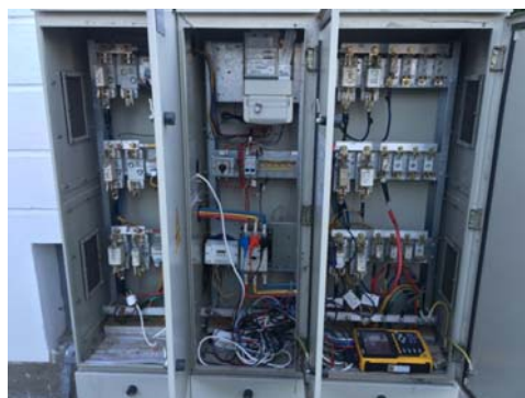
Fig. 1. Măsurarea calității energiei pe circuite de iluminat.
