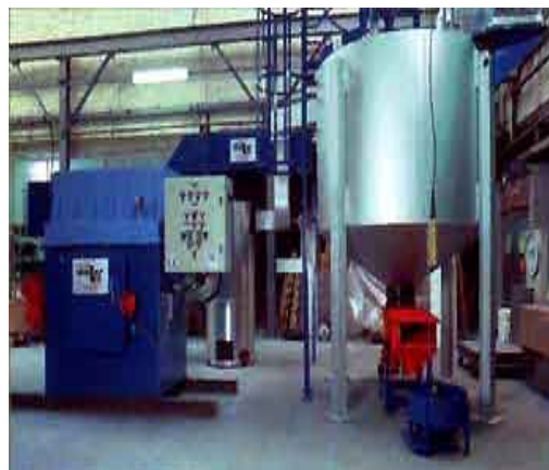
Fig. 4. Incinerator C.P. 50 cu recuperare neutralizarea și filtrarea gazelor [16].
