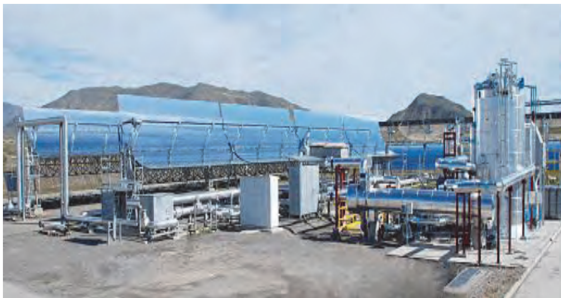
Fig. 4.1. Colectoare cu jgheaburi aparținând centralei solare tip SEGS [9].
