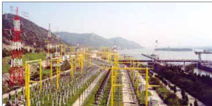
Fig. 3. Porțile de Fier – stația de 400/220 kV re tehnologizată.
